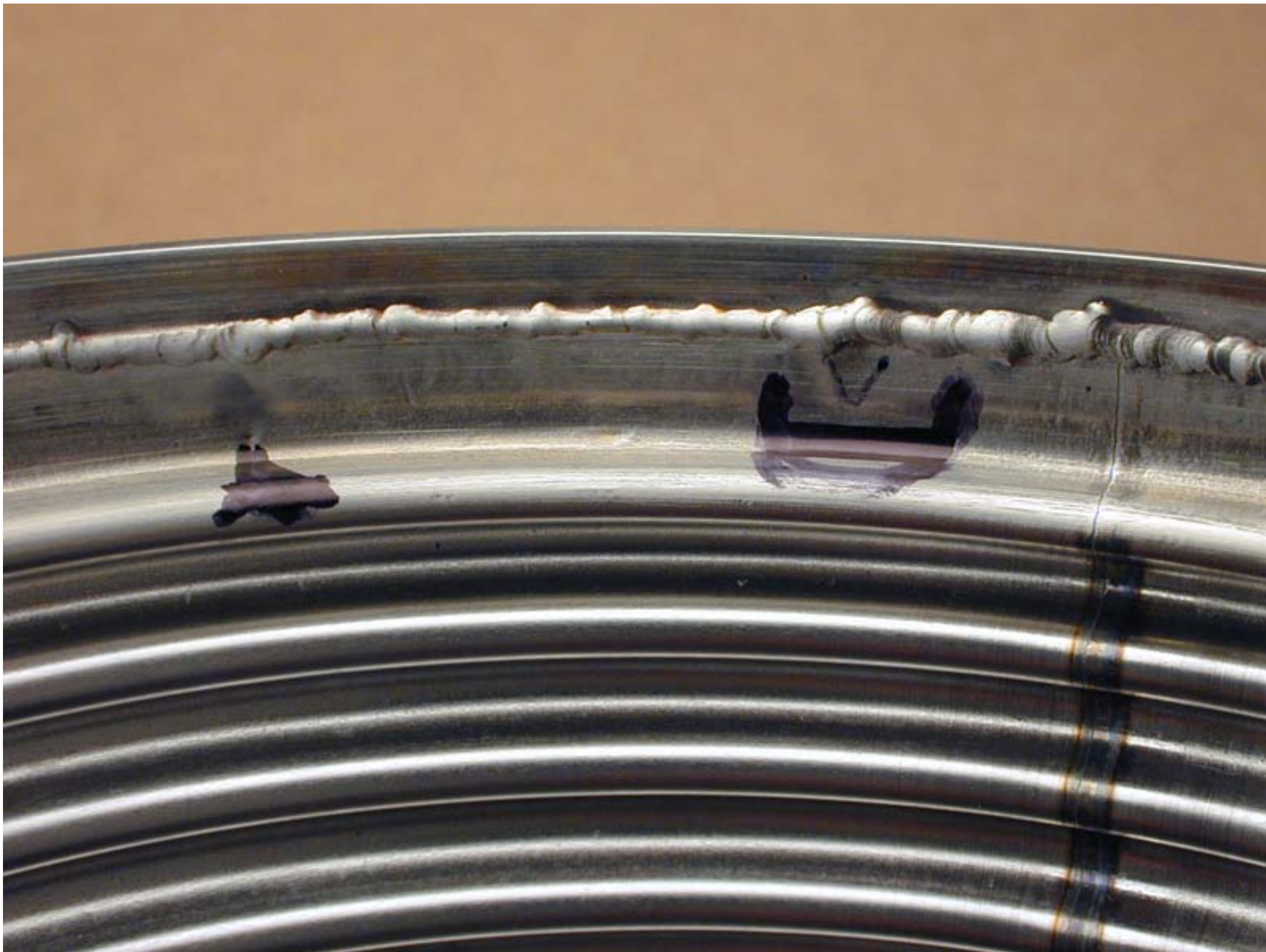
Suspect Weld 8.jpg
