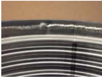
Suspect Weld 2.jpg
