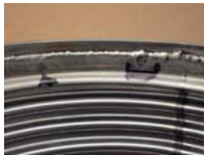
Suspect Weld 8.jpg
