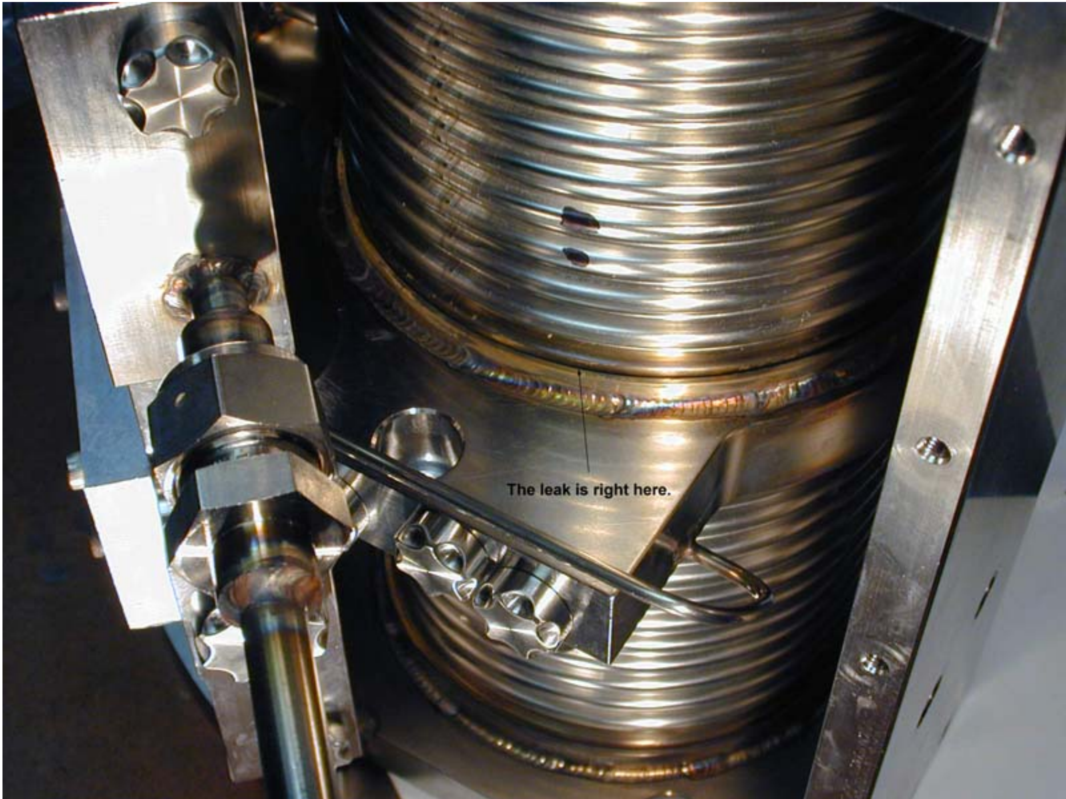
No2 Leak Area 1.jpg
