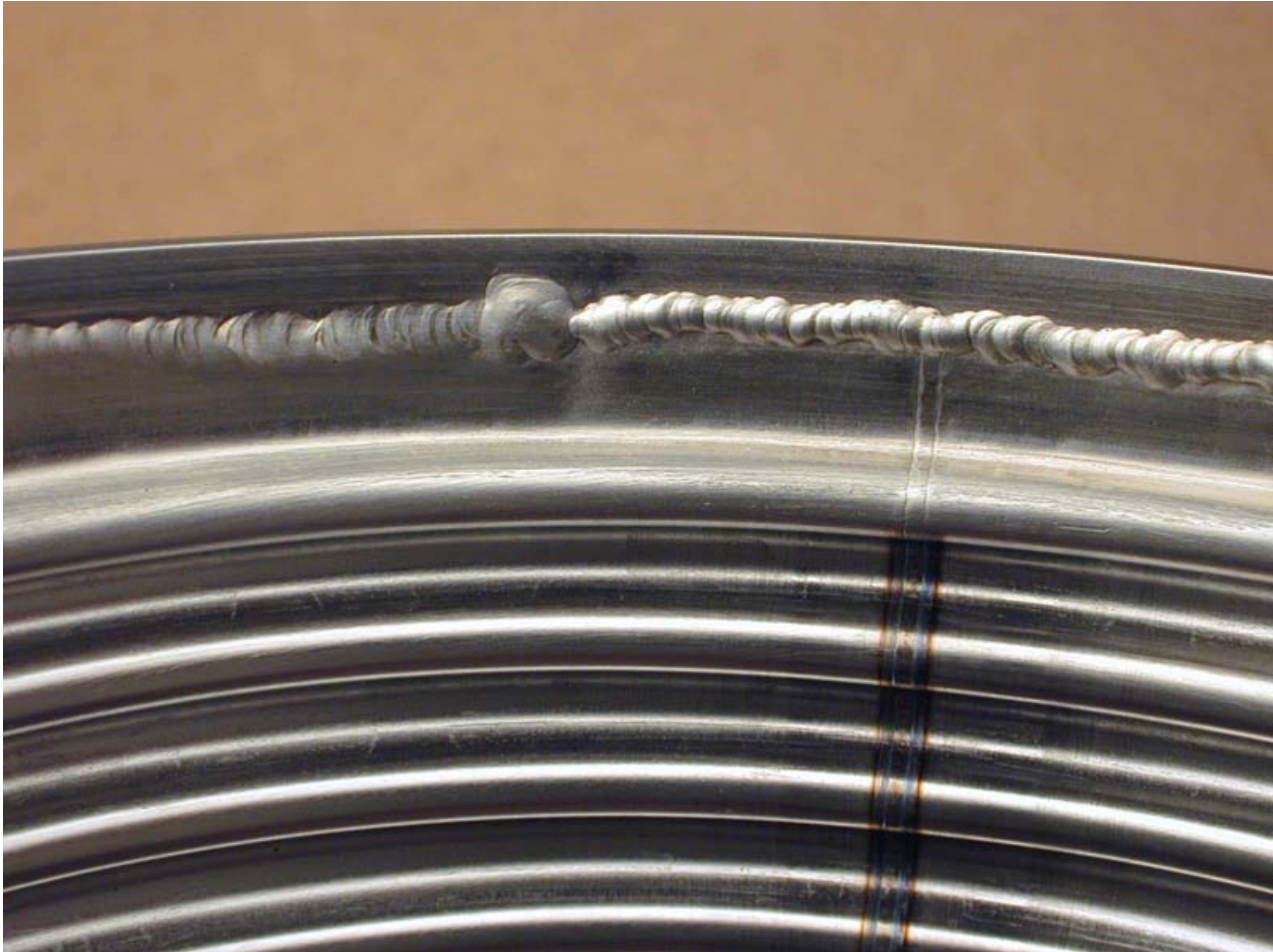
Suspect Weld 2.jpg
