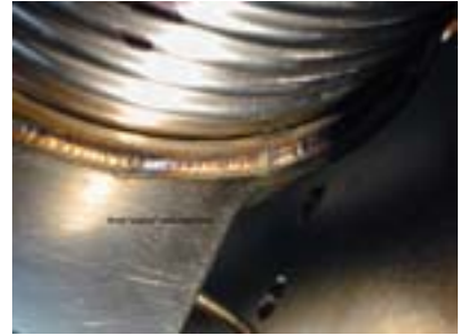
No2 Leak Area 4.jpg
